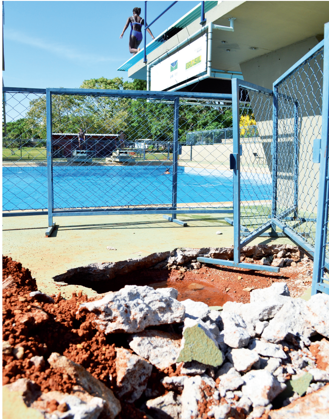
Vazamento interno de uma das piscinas do Centro Olímpico põe em risco as atividades e atletas que treinam no local
