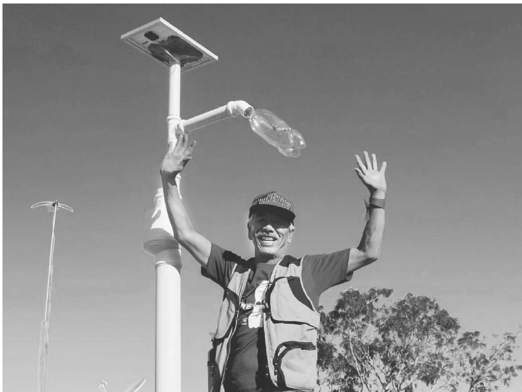
Nelson Toru, da ONG Litro de Luz, instala poste de iluminação fotovoltaica no Sol Nascente | Litro de Luz/Divulgação
